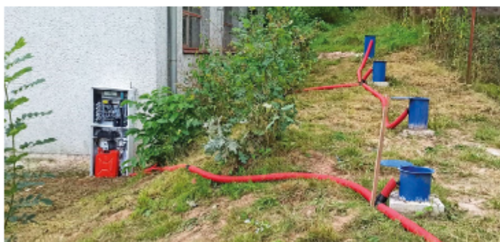
Obrázek 3: Dokončená instalace sanační a monitorovací technologie v lokalitě (instalační sloupek je otevřený pouze pro fotodokumentaci, jinak je uzavřený)
